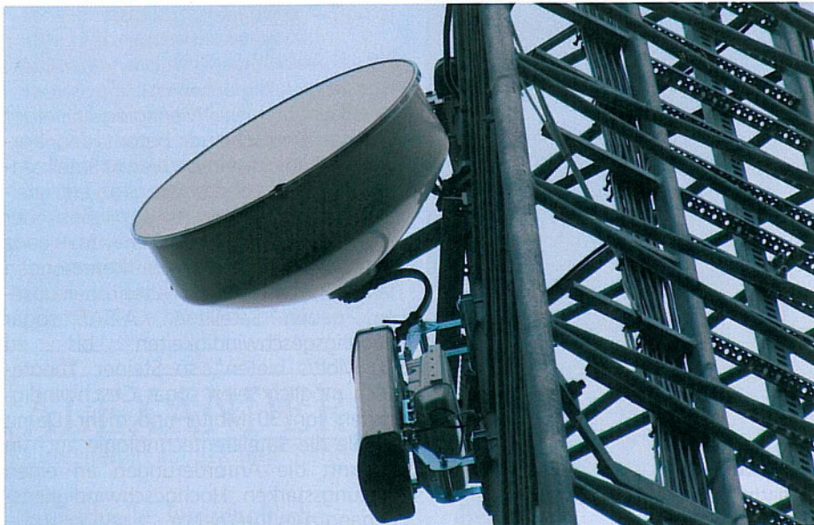
Richtfunkmast: Der Telekommunikationsdienstleister QSC realisiert zusammen mit lokalen Netzanbietern Breitbandservices.
